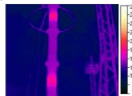
Дефектная (холодная) секция разрядника (снимок сделан тепловизором ТН-5104)
