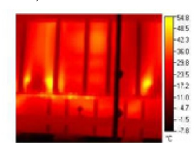
Нагрев болтов крепления и внутренние локальные нагревы бака трансформатора
