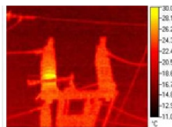
Дефект опорного изолятора (снимок сделан тепловизором ТН-5104)
