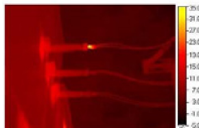
Нагрев контакта на вводе трансформатора (снимок сделан тепловизором ТН-7102)
