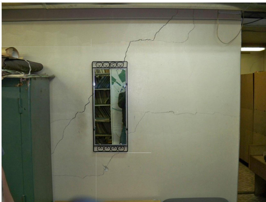
Рис.6. Трещины в стене библиотеки ( t_{\text{вн}} = 17,7^{\circ}\text{C} , t_{\text{стены}} = 15,5^{\circ}\text{C} , t_{\text{трещины}} = 7,6^{\circ}\text{C} )
