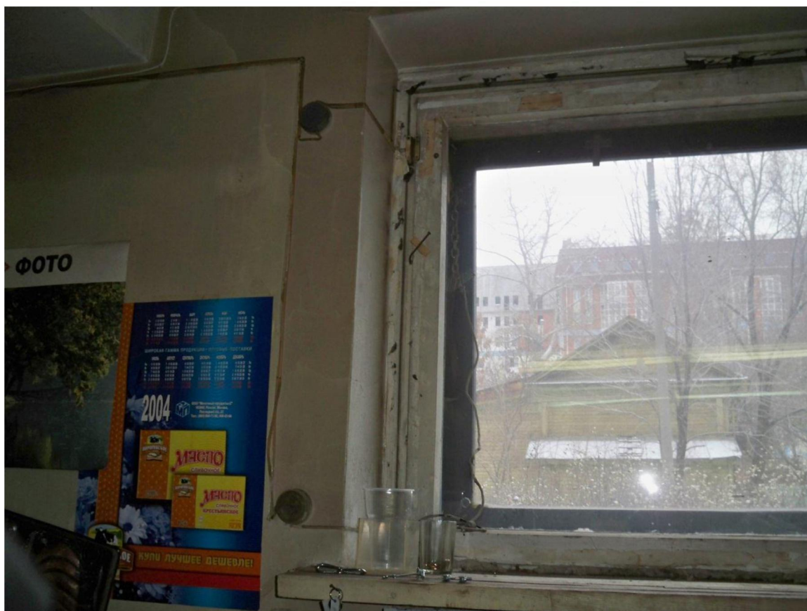
Рис.8. Состояние оконной конструкции кабинета
