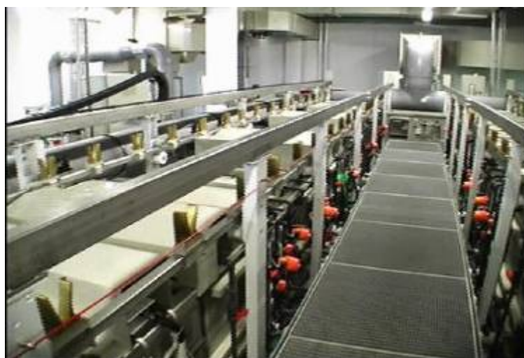
Рис. 4.6. Автоматические линии очистки поверхности и металлизации
