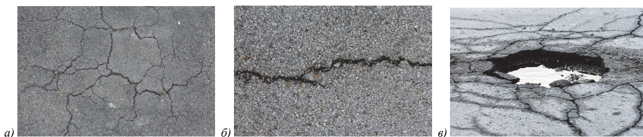
Рис. 1. Изображения дороги, где присутствуют дефекты дорожного покрытия (а – сеточная структура трещин, б – трещина продольная и в – ямы)
