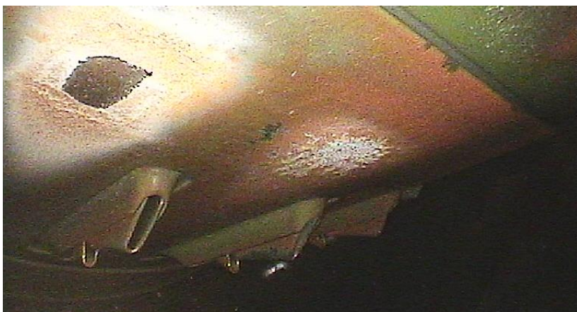
Рис. 22. Нарушение ЛКП КС
