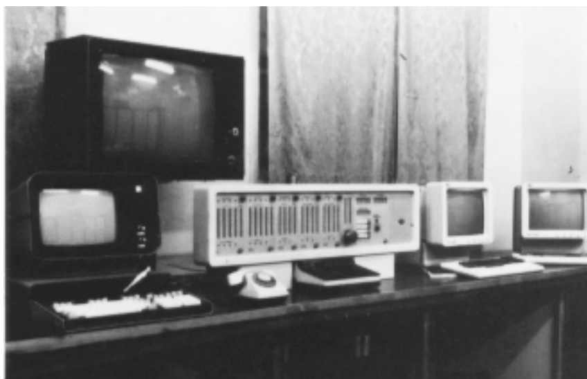
Рис. 4.20. Вид пульта управления испытаниями в пультовой управления экспериментом ЛСИ
