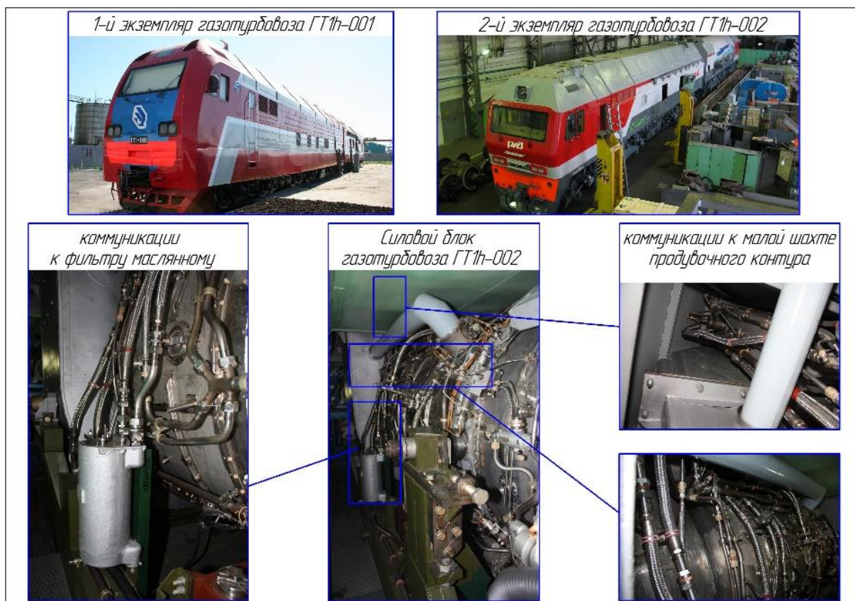
Рис. 2. Трубопроводная обвязка ГТУ НК-361
